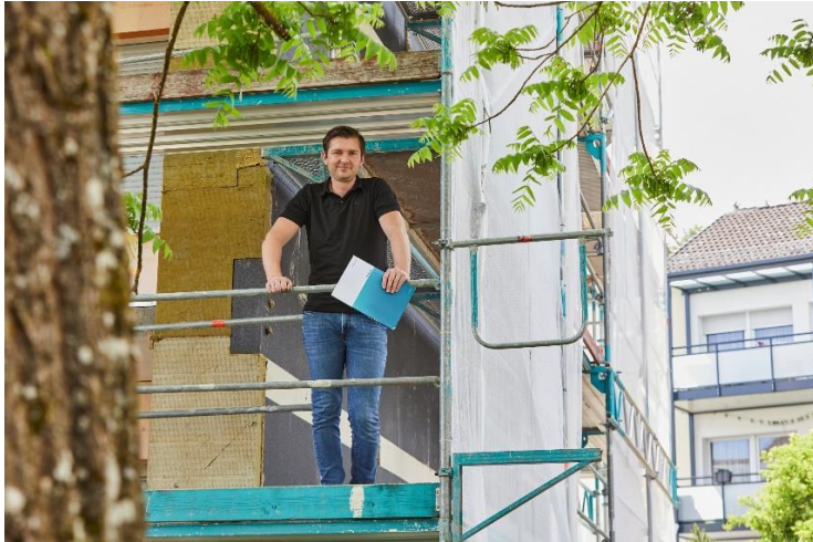
Martin Löhle, Regionalleiter Region Bodensee von Vonovia, inspiziert den Fortschritt der Arbeiten. Quelle: Vonovia
