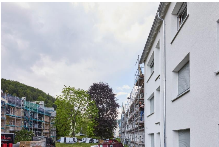
Vonovia treibt umfangreiche Modernisierungs- und Instandsetzungsmaßnahmen in der Wald- und Bismarckstraße voran. Quelle: Vonovia
